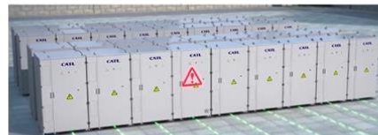
CATL: système composé de 160 unités EnerOne
